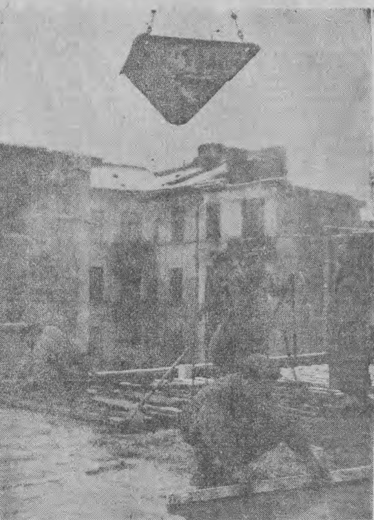
Podążają zimy roboty betoniarzy na Marszałkowskiej Dzielnicy Mieszkaniowej idą „pełną parą”. Na zdjęciu: zakładanie stropów betonowych II piętra na bloku 3b. Foto-AR.
