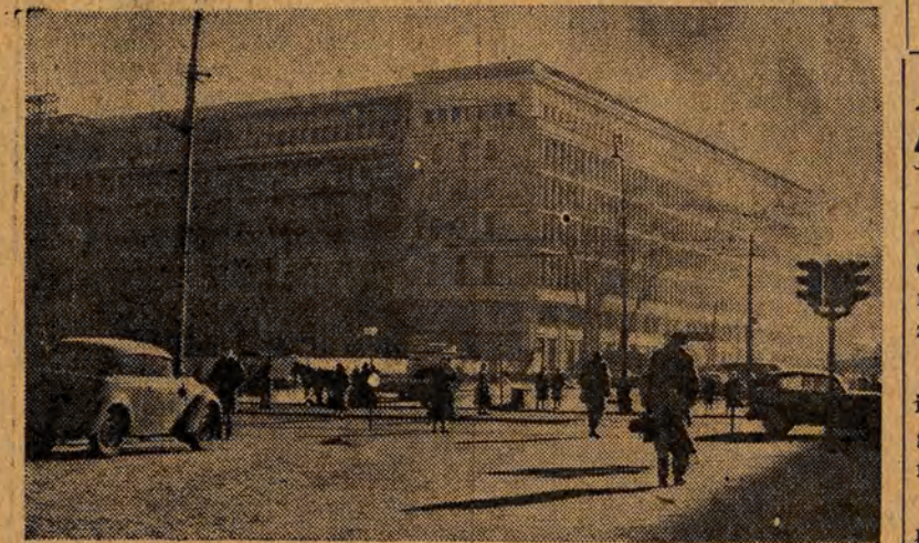
Budowa Domu Partyjnego w Warszawie — siedziby KC PZPR — postępuje szybko naprzód. Został już całkowicie wykończony front wzdłuż ul. Nowy Świat. Obecnie trwają prace przy okładaminie białym piaskowcem fasady wzdłuż Al. Sikorskiego.
