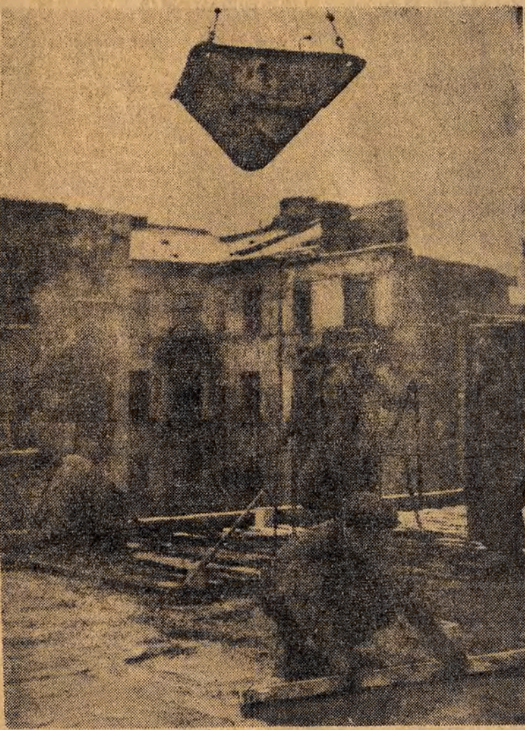
Pomimo zimy roboty betoniarskie na Marszałkowskiej Dzielnicy Mieszkaniowej idą „pełną parą“. Na zdjęciu: zakładanie stropów betonowych II piętra na bloku 3b. Foto-AR.
