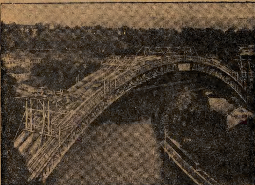
Die Brücke über die Aar in der Schweiz ist ein architektonisches Wunder, da der Brückenbogen die größte Spannweite in Europa hat
