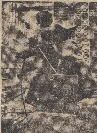
Budowa elektrowni Jaworzno II. Na zdjęciu: Przewodnik pracy, brzdawca — spawacz Edward Kolda, który wykonuje przeciętnie 40% normy. CAF — fe. S. Wdowiński
