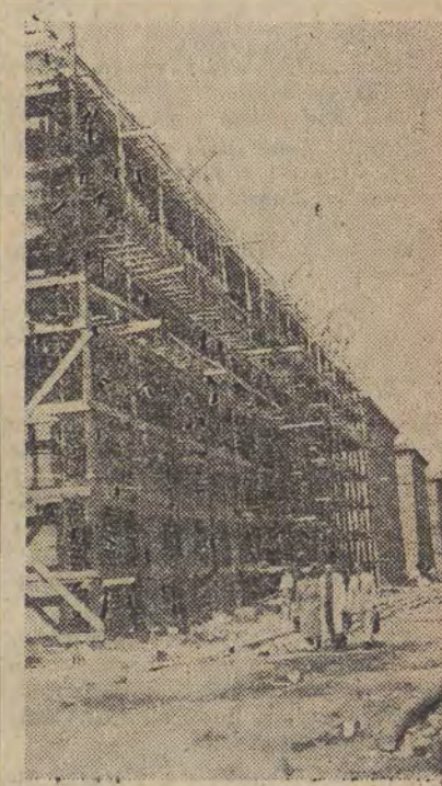
W Warszawie na zapleczu ulicy Nowy Świat buduje się tzw. ciąg pleszy. Na zdjęciu: fragment budowy ciągu pleszego między ul. Foksal a ul. Ordynacką. CAF - fot. Adam Mottl
