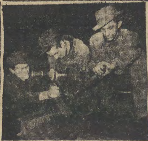
CEMENTOWNIA „ODRA” W OPOLU. Na zdjęciu: brygada młodzieżowa w składzie: Aleksander Rosol, Jan Grzebielac i Hubert przy naprawie prowadzącej pieców. CAF — fot. Dz. Wdowiński
