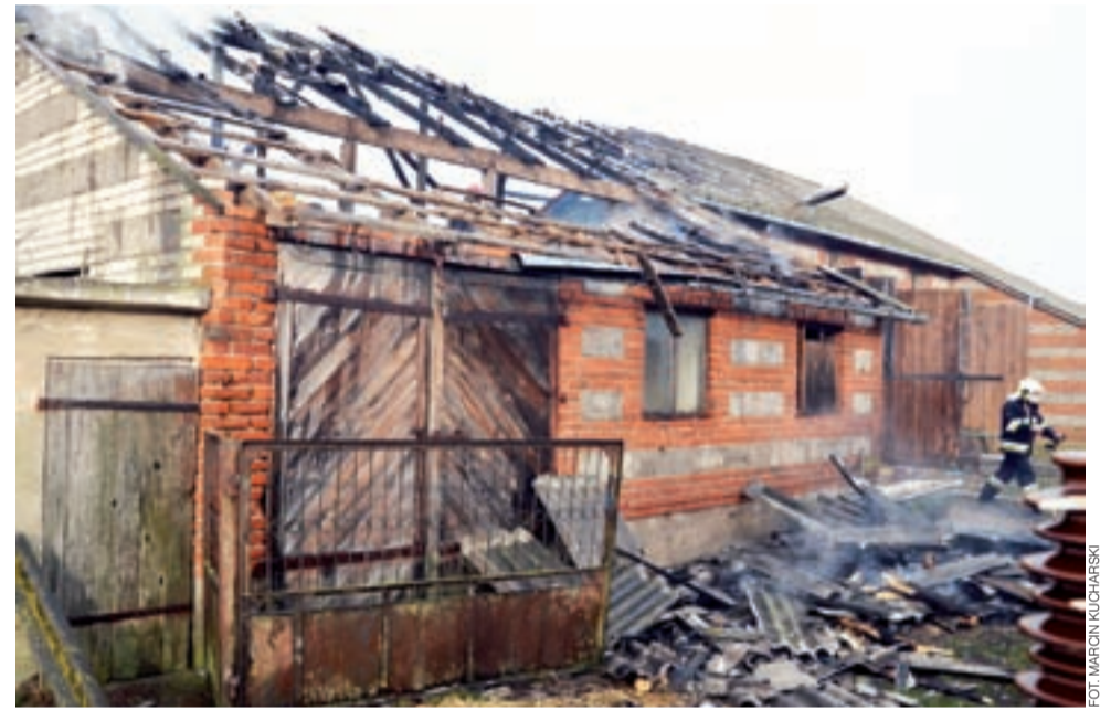
Konstrukcja dachu nadaje się po pożarze tylko do rozbiórki.
