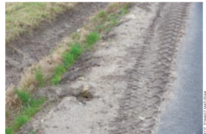
Między Wiciem a Boczkami Chełmońskimi widać co stało się z gruntowym poboczem po przejechaniu ciężkiego pojazdu.
