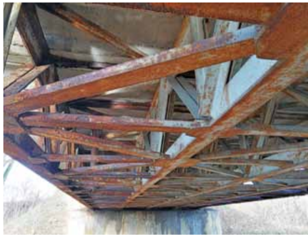
Skorodowana konstrukcja mostu.
