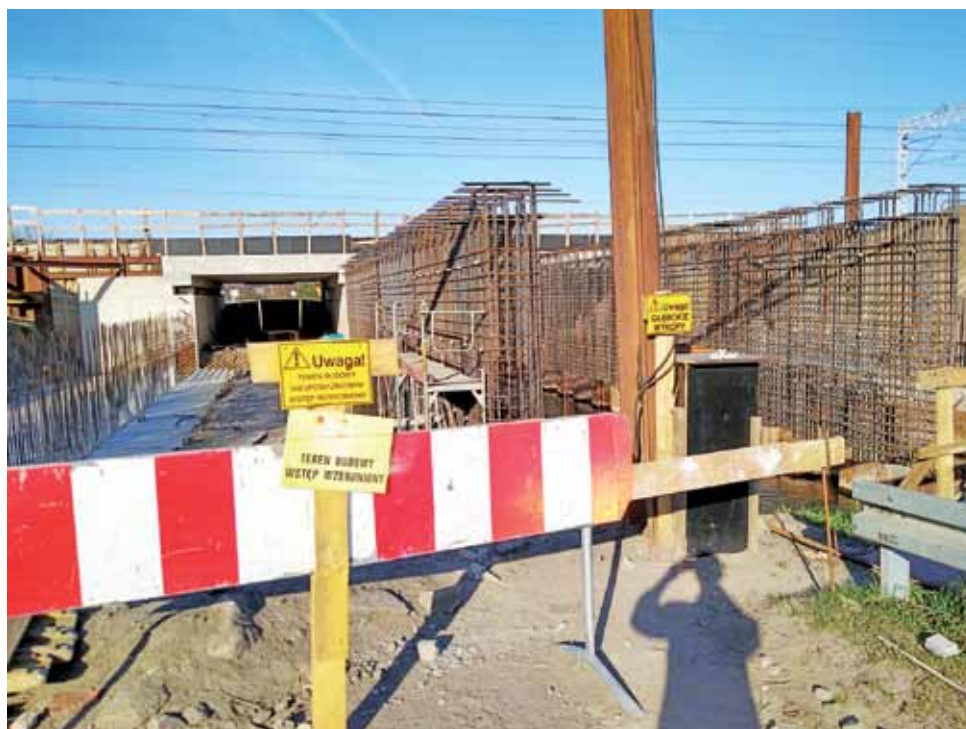
Prace przy ul. Arkadyjskiej skupiają się obecnie na zbrojeniu filarów widocznych w tle.
