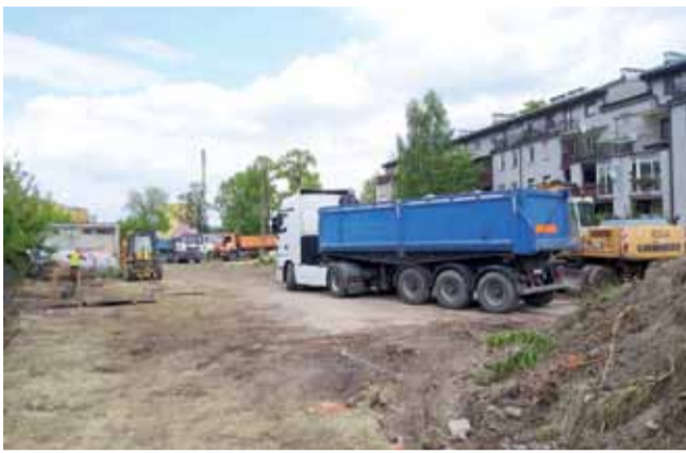
Teren budowy nowego sklepu DINO przy ul. Bolimowskiej. Obecnie prace skupiają się na przygotowaniu gruntu pod fundamenty.
