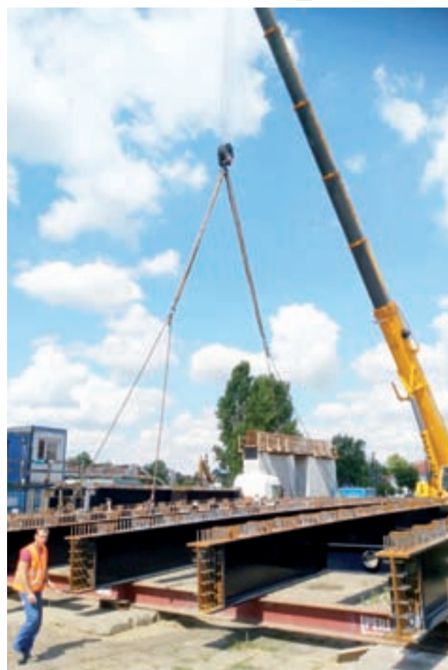
Pierwsze pięć dźwigarów, o długości ponad 25 m każdy, już trafiło na budowę wiaduktu.
