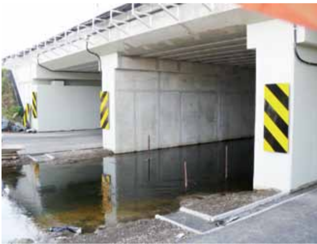
Poziom wody w Zwierzyncu jest faktycznie wysoki. Uniemożliwia on montaż barier energochłonnych, przy samym korycie.
