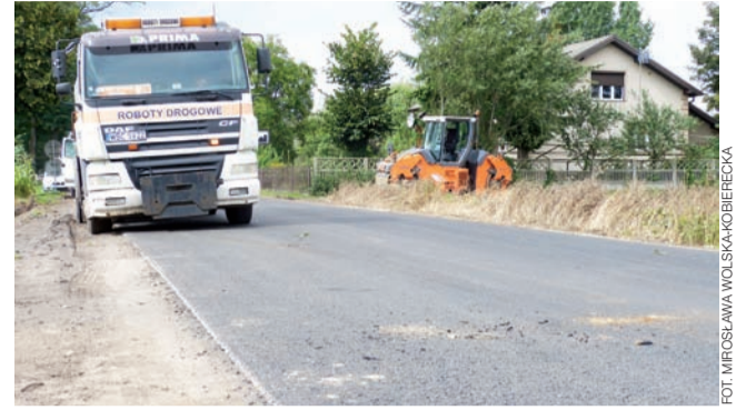
W ubiegłym tygodniu prace prowadzone były na odcinku w Kocierzewie Płd., blisko ośrodka zdrowia.
