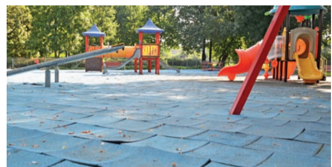
Nawierzchnia z kostek na obu placach się nie sprawdza.
