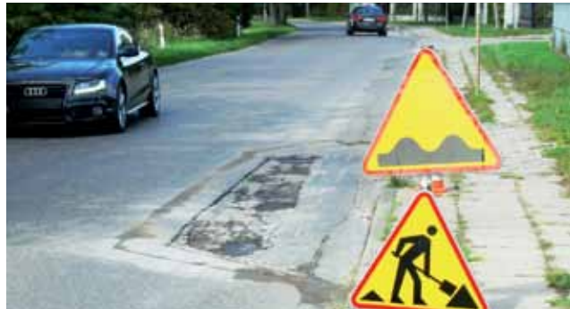
We wrześniu Zakład Utrzymania Miasta naprawiał nawierzchnię na ul. Nadburzańskiej, w miejsca spęknięcia i dziur położono nowy asfalt.
