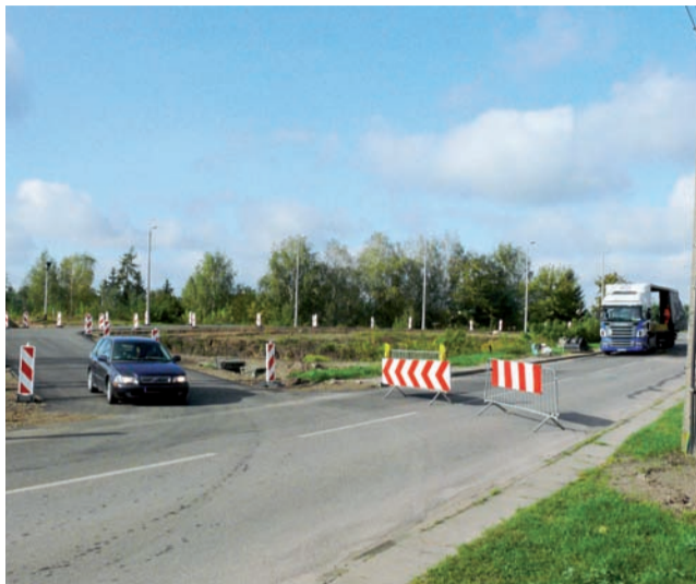
Tymczasowy objazd wokół przejazdu kolejowego w ul. Klickiego jest dość wąski, a granice jezdni wyznaczają ustawione znaki. Niestety na chodnik dla pieszych zabrakło miejsca.
