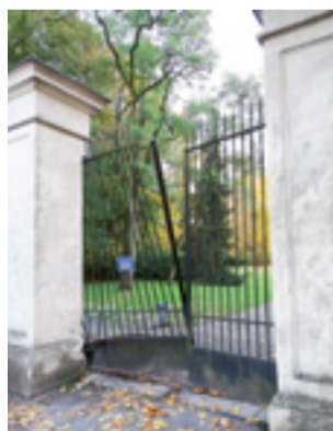
Zniszczona przez pijanego kierowcę brama wjazdowa na teren muzeum w Nieborowie.
