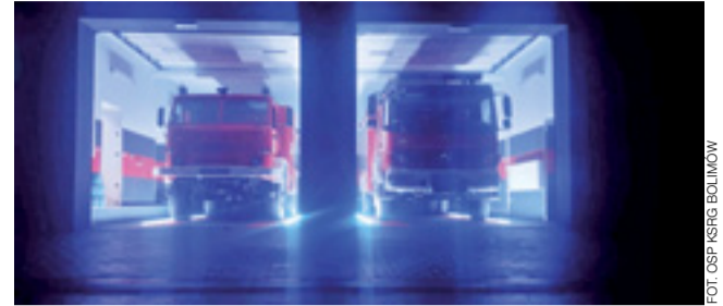
Na podłodze zamontowano linie ze świateł LED, by ułatwić kierowcom wjazd i wyjazd. FOT. OSP/ISRG BOLIMÓW
