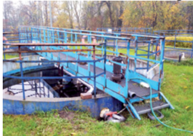
Na terenie oczyszczalni ścieków w Domaniewicach powstają m.in. nowe reaktory, w których ścieki są m.in. napowietrzane i wstępnie oczyszczane.
