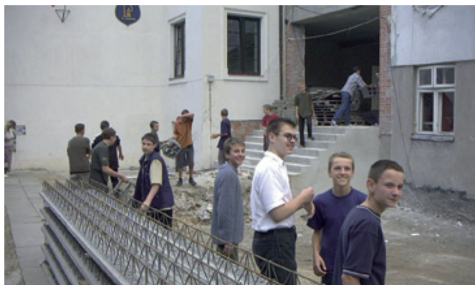
11 września 2002 r. Uczniowie szkoły pijarskiej pomagali rozładowywać pustaki na strop rozbudowywanej szkoły.
