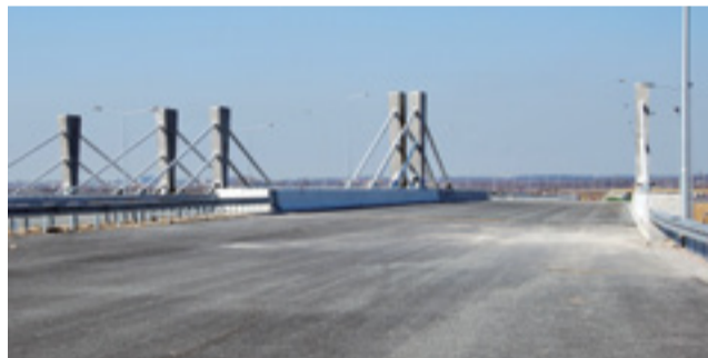
Od razu po stwierdzeniu pęknięć GDDKiA postanowiła wyłączyć wiadukt z ruchu.
