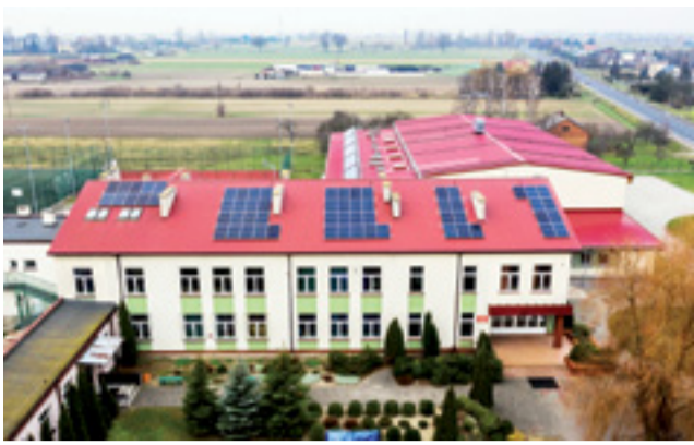
Tak wyglądają solary o mocy 40 kW, zamontowane na budynku Szkoły Podstawowej w Nowych Zdunach.
