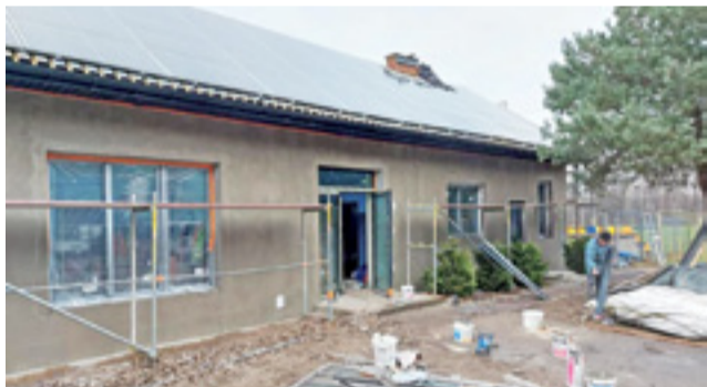
Budynek zaplecza boiska w Bełchowie jeszcze kilka dni temu w czasie prowadzonych prac.
