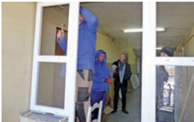
Okna na klatce schodowej bloku Konopnickiej 1 wymieniali pracownicy spółdzielni. To jedna z prac tego roku.
