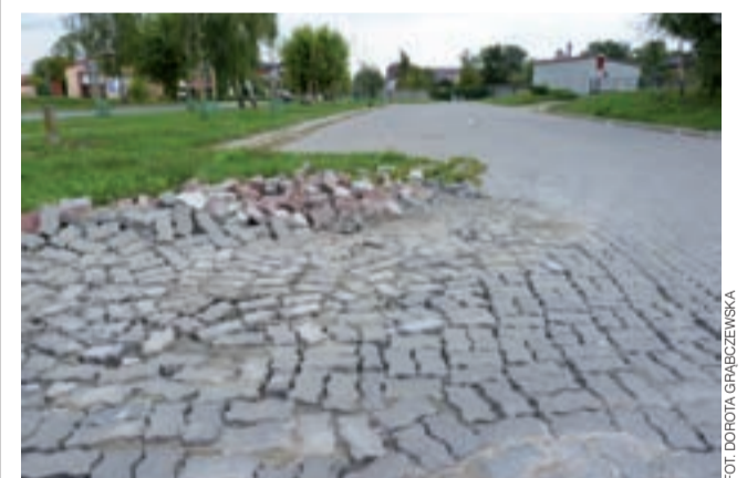
Wjazd na parking przy Orłowskiego od kilku miesięcy jest zrujnowany.
