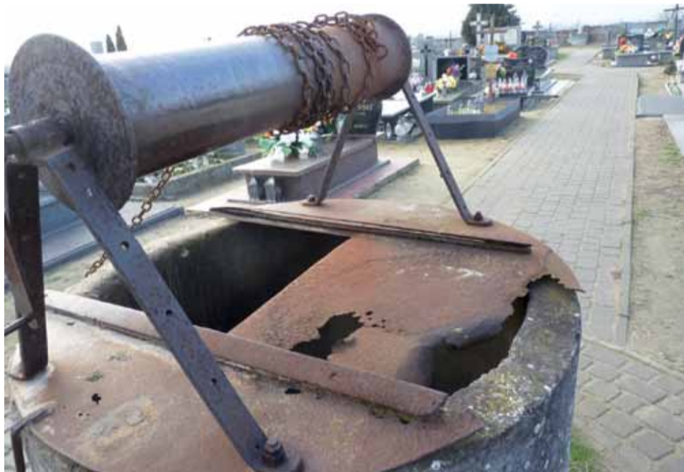
Metalowa pokrywa zabezpieczająca na cmentarnej studni w Żychlinie jest mocno skorodowana i niebezpieczna.
