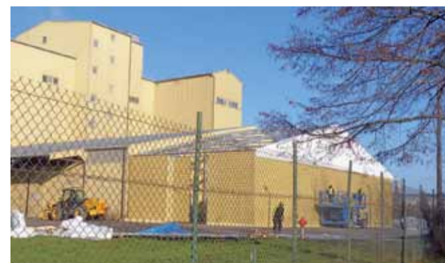
W piątek, 17 stycznia, trzeciego dnia pracy, firma już układała dach na nowej hali magazynowej
