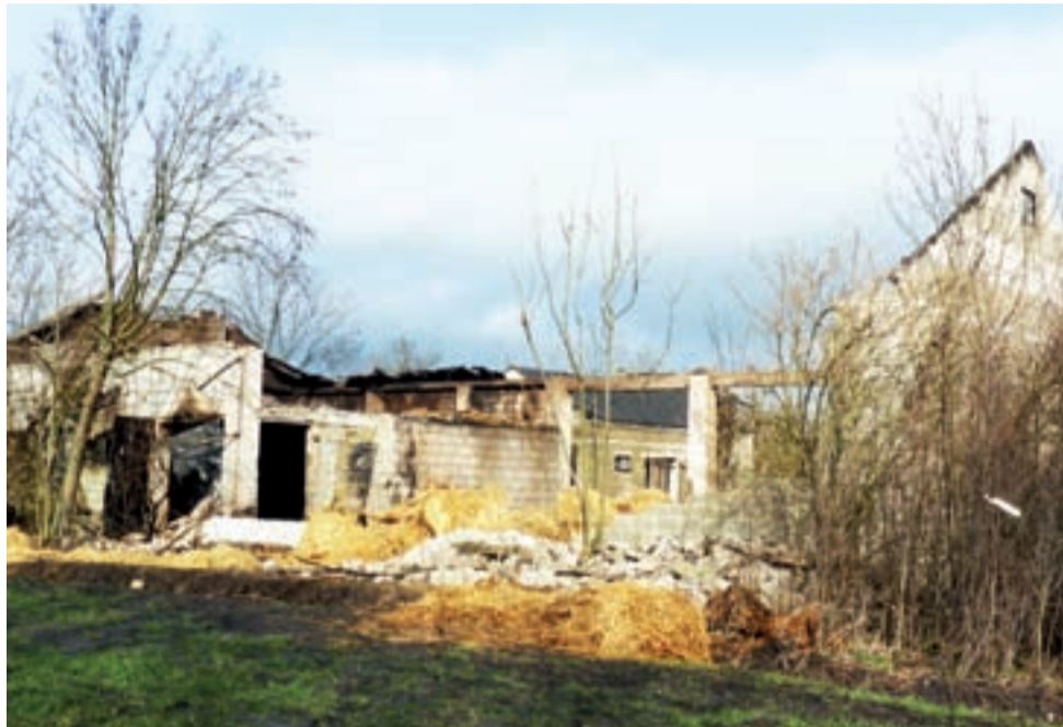
Z murowanej stodoły wypełnionej belkami słomy niewiele pozostało. Mury są popękane, nadają się do rozbiórki.
