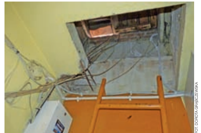
Na korytarzu bloku Konopnickiej 5a wąż na dach jest nieszczelny. Szpara o wysokości ok. 5 cm wpada nie tylko zimne powietrze, ale też deszcz, który zalewa ścianę łazienki jednej z lokatorek oraz korytarz.
