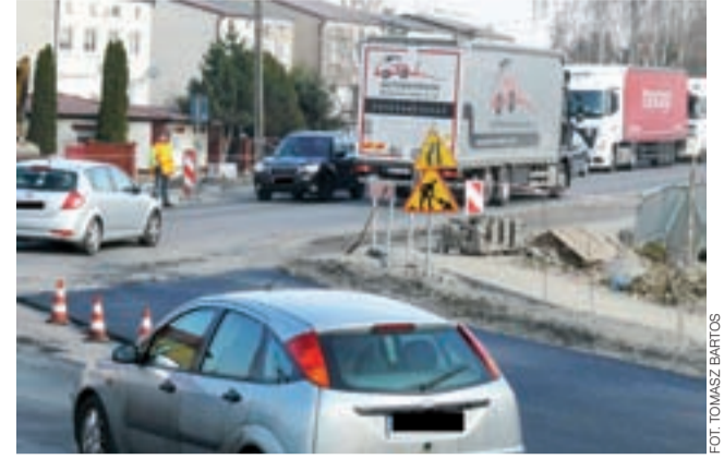
Połączenie drogi technicznej od strony ulicy Bolimowskiej z ul. Warszawską, w czasie układania nowej nawierzchni.
