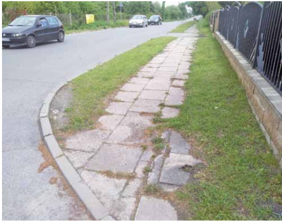
Stary Chodnik wzdłuż ulicy Targowej w Głownie jest już od dawna w złym stanie.
