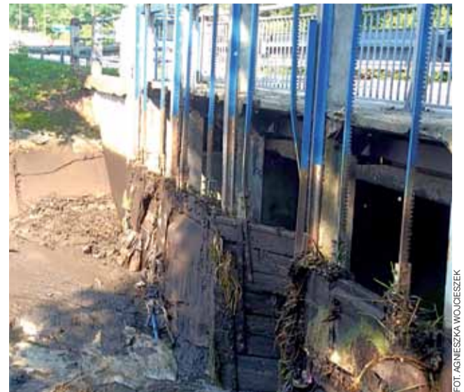
W tym miejscu doszło do wycieku wody. Prawdopodobną przyczyną było uszkodzenie stawideł.
