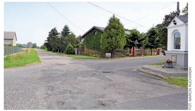
Droga w Wyskokach była już wielokrotnie łamana i naprawiana. Teraz będzie nowa warstwa asfaltu.
