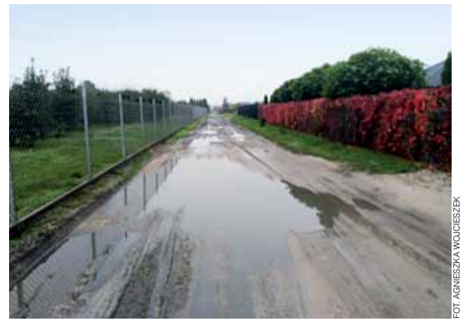
Jedno wielkie błotne koryto. Tak po deszczu prezentuje się ul. Graniczna.
