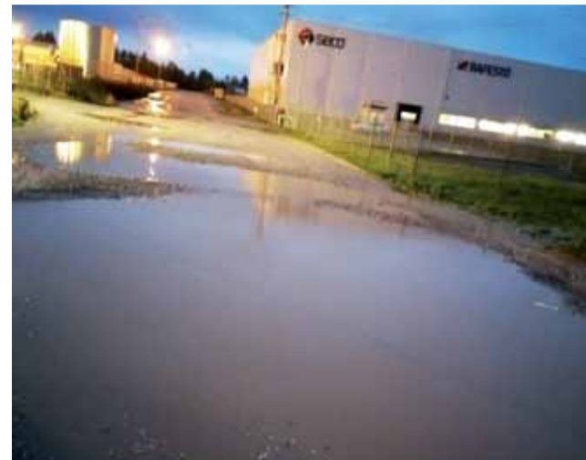
Druga dojazdowa do magazynów po ulewie.
