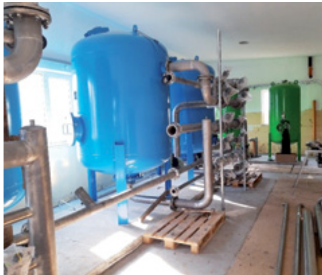
Znacząco zmieniła się ostatnio Stacja Uzdatniania Wody w Boczku Domaradzkim, a to jeszcze nie koniec modernizacji.
