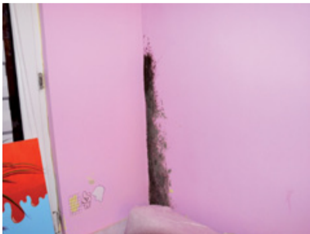
A tak wygląda ściana w rogu małego pokoju mieszkania, od strony klatki schodowej.
