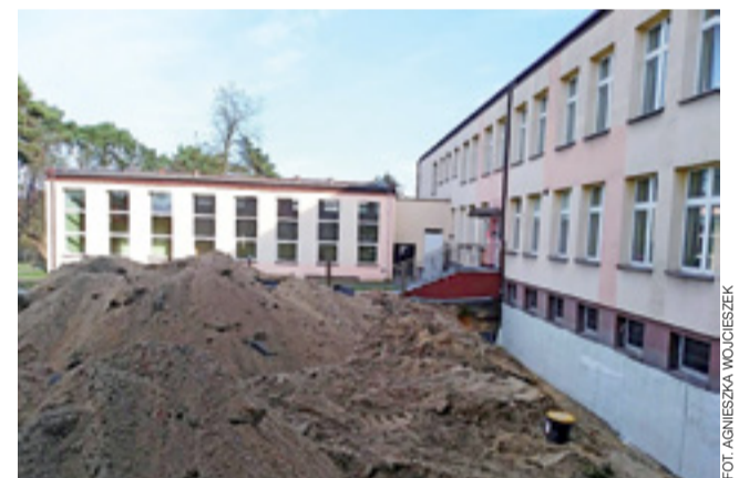
Prace na terenie I LO. By zapewnić bezpieczeństwo, konieczne jest także przeprowadzenie osuszania wewnętrznego.
