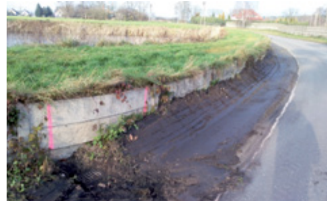
Woda na łuku tej drogi odprowadzana jest powierzchniowo – nieutwardzonym poboczem.
