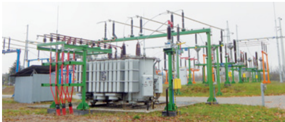
Stacja WN/SN Łowicz, 1 położona przy ulicy Sochaczewskiej, zapewnia dostawy energii do dużej części odbiorców z północnej części Łowicza i powiatu łowickiego.
