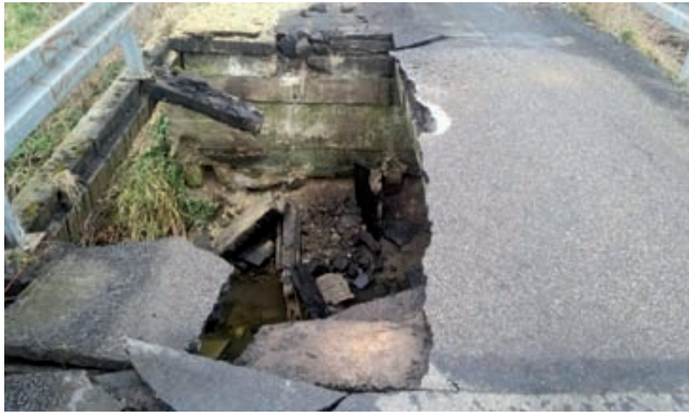
Zarwany most w na ul. Spacerowej w Bednarach. Połowa legła w korycie przepływającej pod nim strugi.
