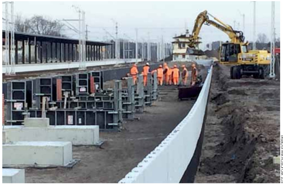
Prace na peronie 2. Widać południową ściankę peronu i fundamenty pod filary wiaty.
