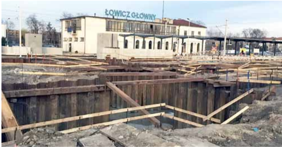
Bez tych stalowych ścian prace w głębokim wykopie pod przejście podziemne nie mogłyby się odbywać.
