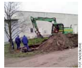
Pracownicy Przedsiębiorstwa Wodociągów i Kanalizacji szybko uporali się z awarią kanalizacji ściekowej. Mieszkańcy nie odczuli skutków awarii.
