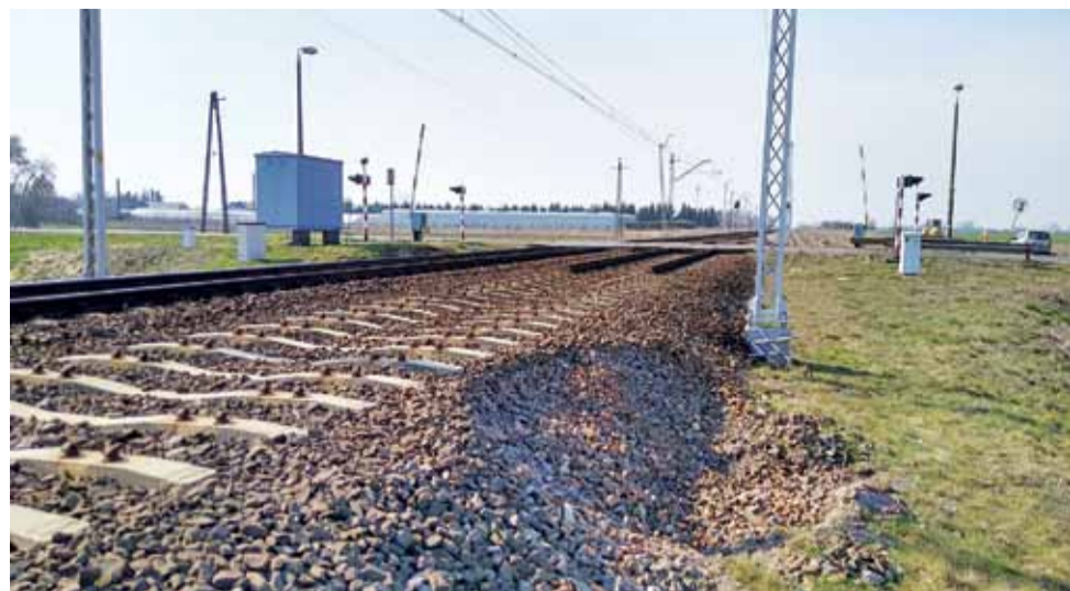
Zdemontowane szyny przy przejeździe na ul. Płockiej. Ruch w stronę Kutna odbywa się na jednym torze.
