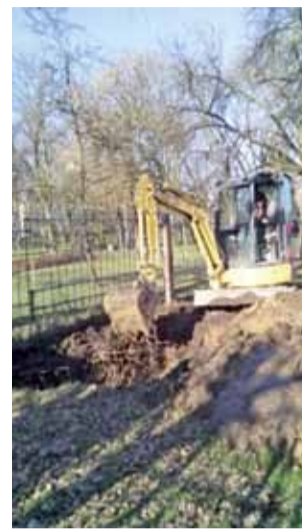
Awarię wodociągu usuwano
