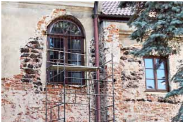
Najstarszy fragment odsłoniętej zabudowy, powstałej jeszcze w XV wieku (do widocznego przepierzenia).
