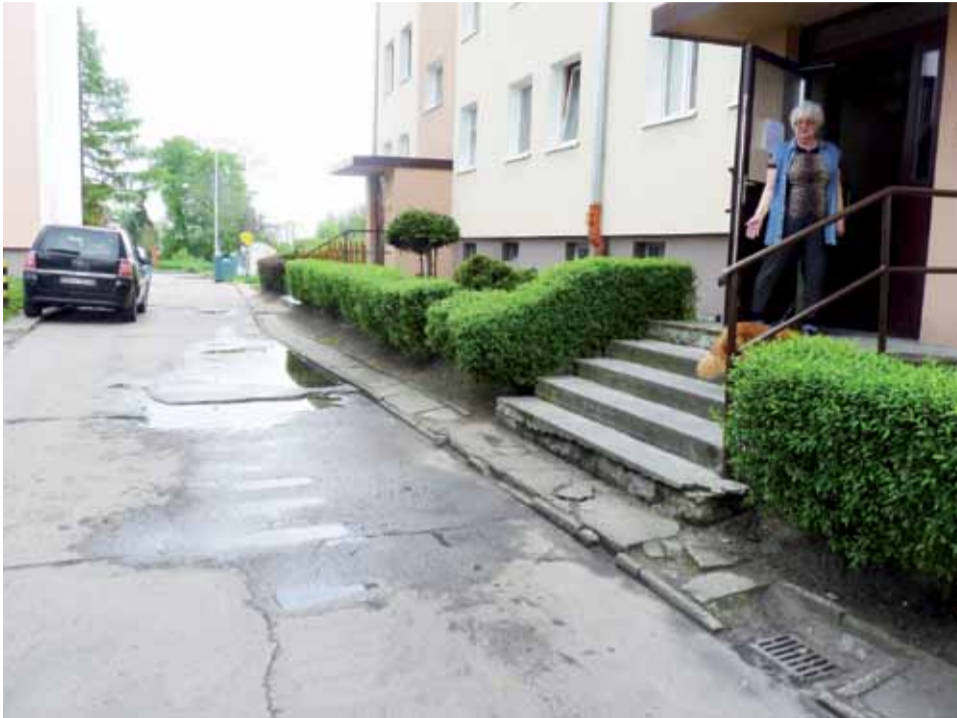
Mieszkańcy bloku Traugutta 26 oczekują na remont schodowych podestów i budowę chodnika, którego teraz praktycznie nie ma.
