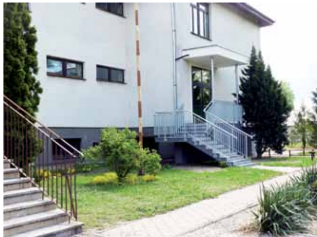
W maju w SP Żeronice nastąpił odbiór techniczny wybudowanego nowego osobnego wejścia dla przedszkolaków.
