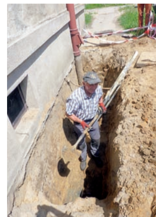
Pracownicy Spółdzielni mieszkaniowej Wspólny Dom odkopali rurę spustową odprowadzającą wodę z dachu bloku Narutowicza 85a.
