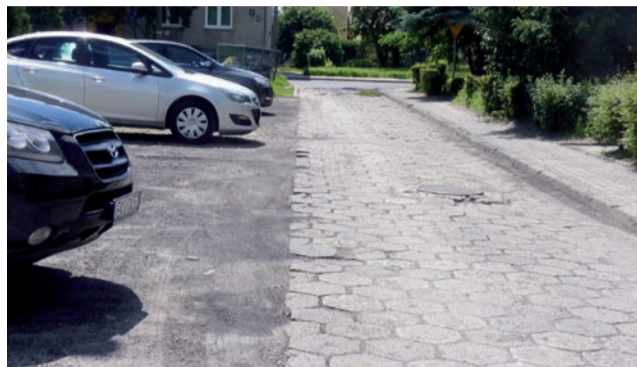
Osiedlowa uliczka wzdłuż Narutowicza a, b, c i f czeka na remont. Teraz wygląda jak fale Dunaju, z licznymi zapadliskami.
