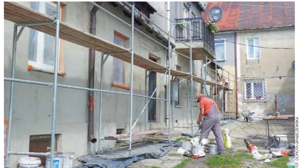
Od strony podwórka budynek przy ul. Narutowicza 2 nie będzie docieplany. Ściany są tylko wyrównane, zakładana siatka wzmacniająca i ma być tynk mineralny. Od frontu budynek zostanie docieplony 10 cm warstwą styropianu.
