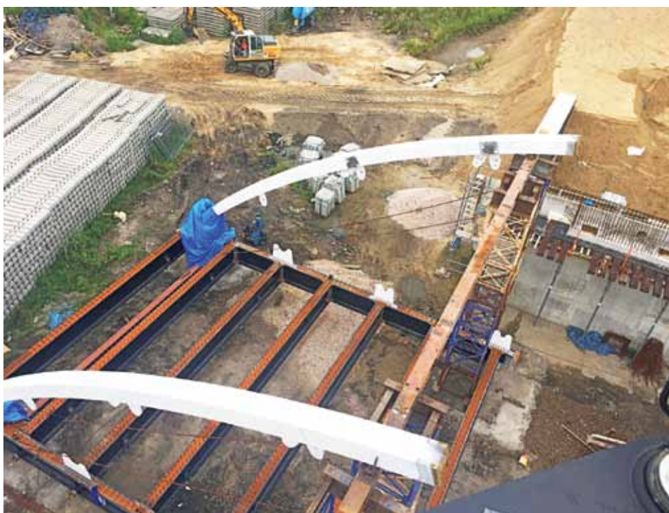
Tak wyglądał pierwszy segment konstrukcji łukowej wraz z elementami jezdni w ubiegłym tygodniu...
