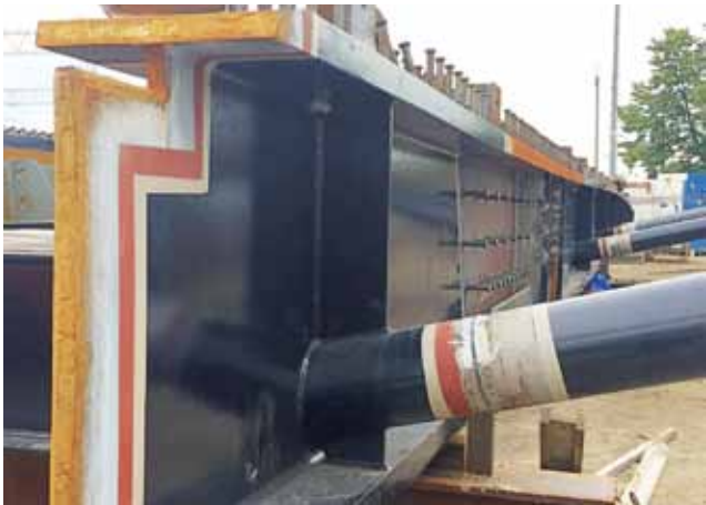
Na elementach gotowych widać iloma warstwami substancji ochronnych są pokryte. Spawy będą tak samo konserwowane.
