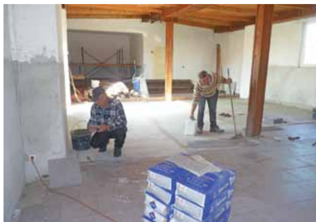
Drewnianą boazerię ze ścian w świetlicy w Kurowie zerwano. Trwa układanie płytek gresowych na podłodze.
