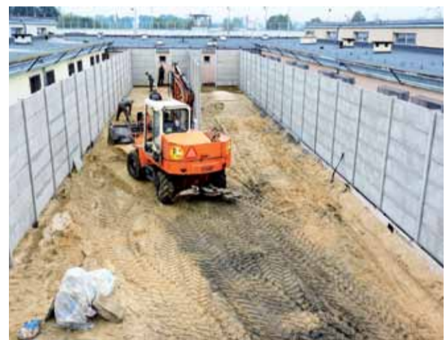
Na tym etapie prac wyraźnie widać już zarys kształtu przyszłego placu spacerowego.
