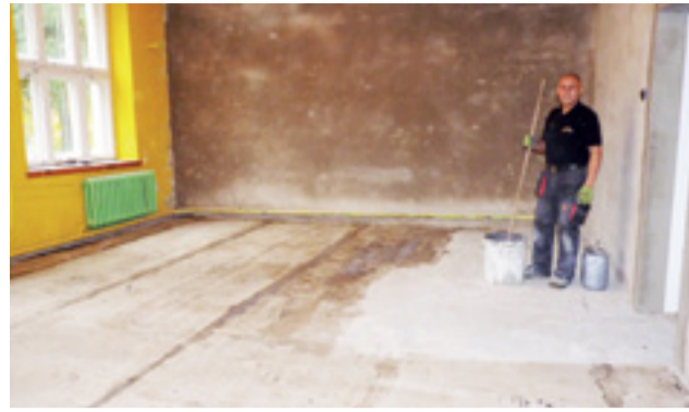
W salce gimnastycznej w SP Plecka Dąbrowa przygotowywane jest podłoże pod ułożenie sportowej nawierzchni.
