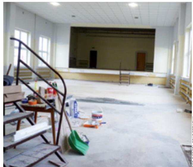
Trwa remont w sali widowiskowej GOK w Bedlnie. Wkrótce rozpocznie się układanie parkietu.
