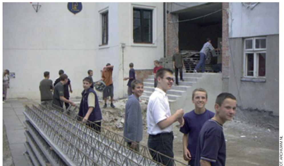
11 września 2002 r. Uczniowie szkoły pijarskiej pomagali rozładowywać pustaki na strop rozbudowywanej szkoły.
