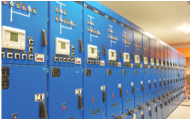
Szafy z zabezpieczeniami poszczególnych linii na rozdzielni 15 kV, przy ul. Sochaczewskiej.
